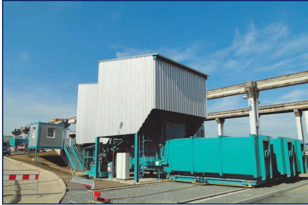
• Umladestation mit Querverschiebeanlagen für 3 Presscontainer
